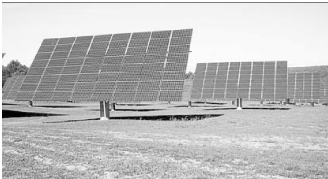
Vista d'un parc fotovoltaic instal·lat en una zona rural
