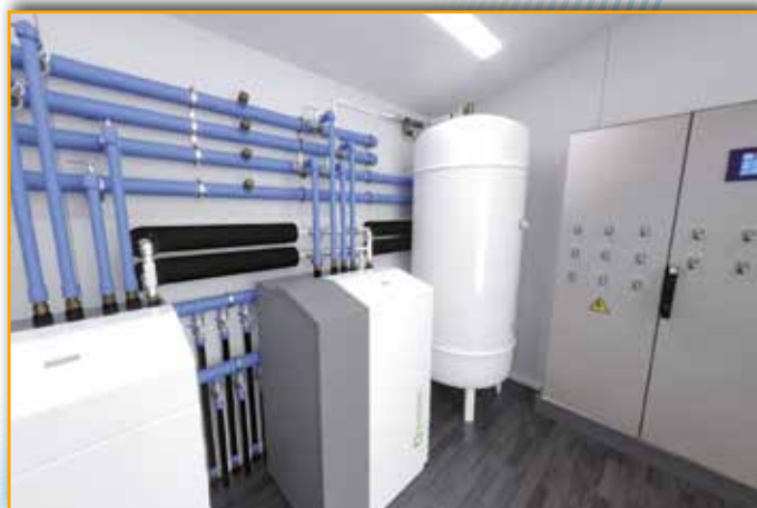
Interior caseta tècnica (geotèrmia i tractament d'aigua)
